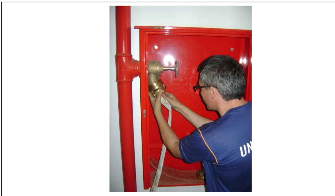
Imagem 1 – Engate da mangueira no registro do hidrante
