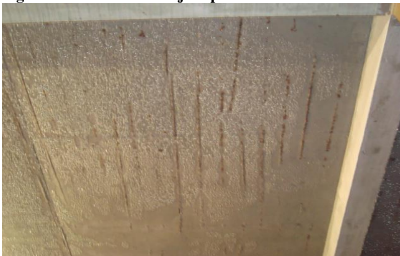
Figura 6 – Corrosão da laje superior do reservatório
