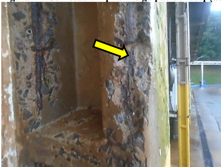
Figura 4 – Corrosão em pilar no galpão de recepção
