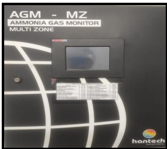
Figura 5 – Central do sistema de detecção de amônia.
