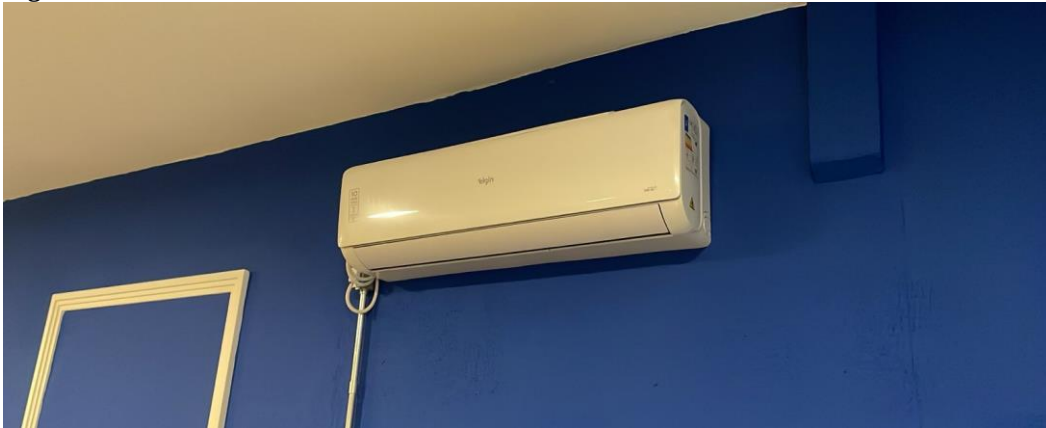
Figura 2- Ar condicionado 30.000 btus
