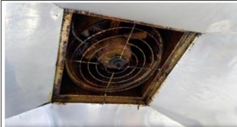
Figura 4 - Acúmulo de gordura no exaustor axial.
