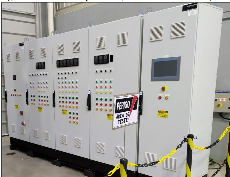
Figura 2 – Painel elétrico para FFO (Fábrica de Farinha e Óleo).
