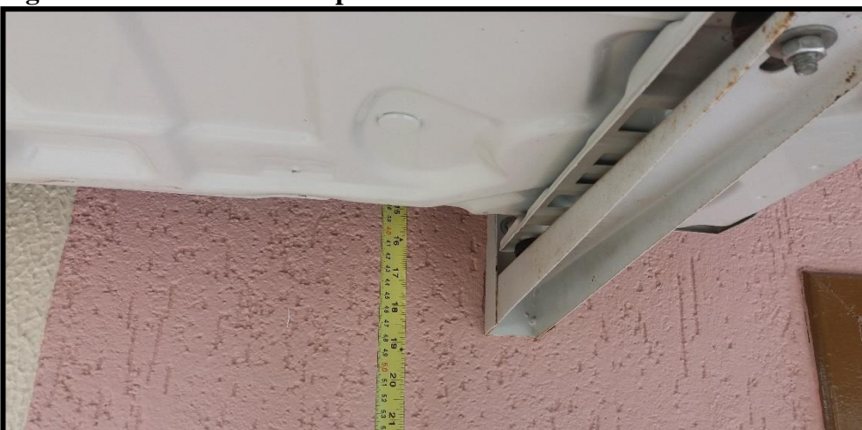
Figura 6- desnível entre evaporador e condensador
