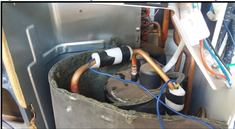
Figura 7- sensores de temperatura na entrada e saída do compressor
