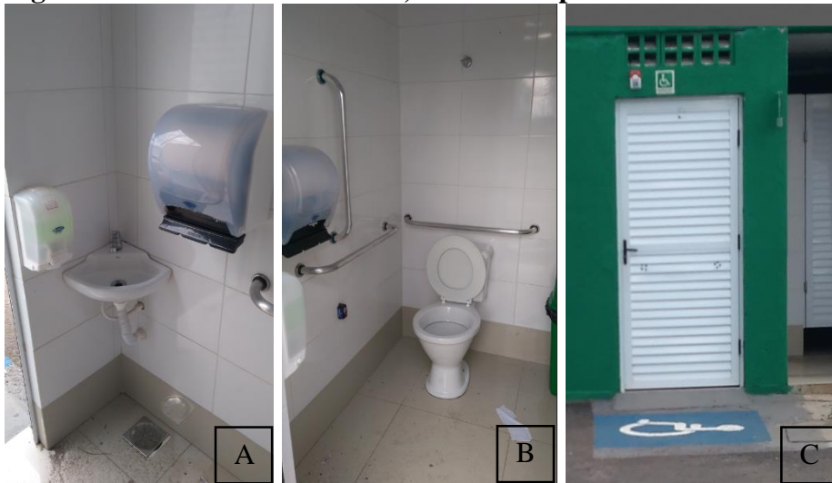
Figura 8 - Lavatório sem barras, barras de apoio fora das medidas e falta de sinalização
