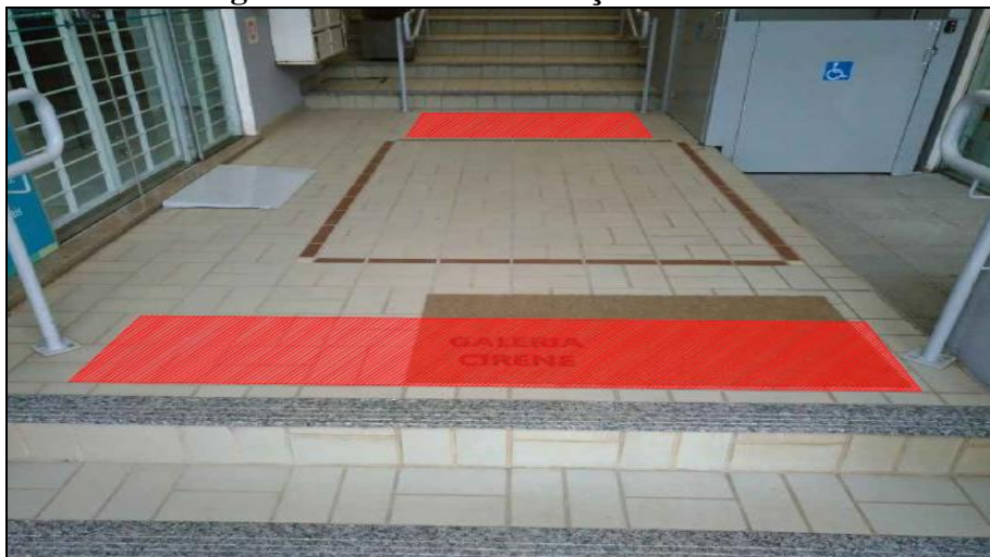
Figura 3: Falta de sinalização tátil alerta
